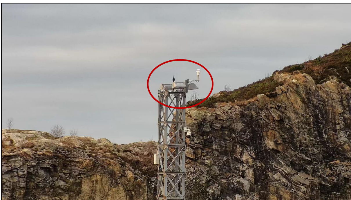
Figur 1-3: Bilde av målestasjon i måleposisjon 1 iht. Figur 1-1. Målestasjonen er plassert i toppen av masten på industriområdet. Målestasjonen henter også inn meteorologiske data.
